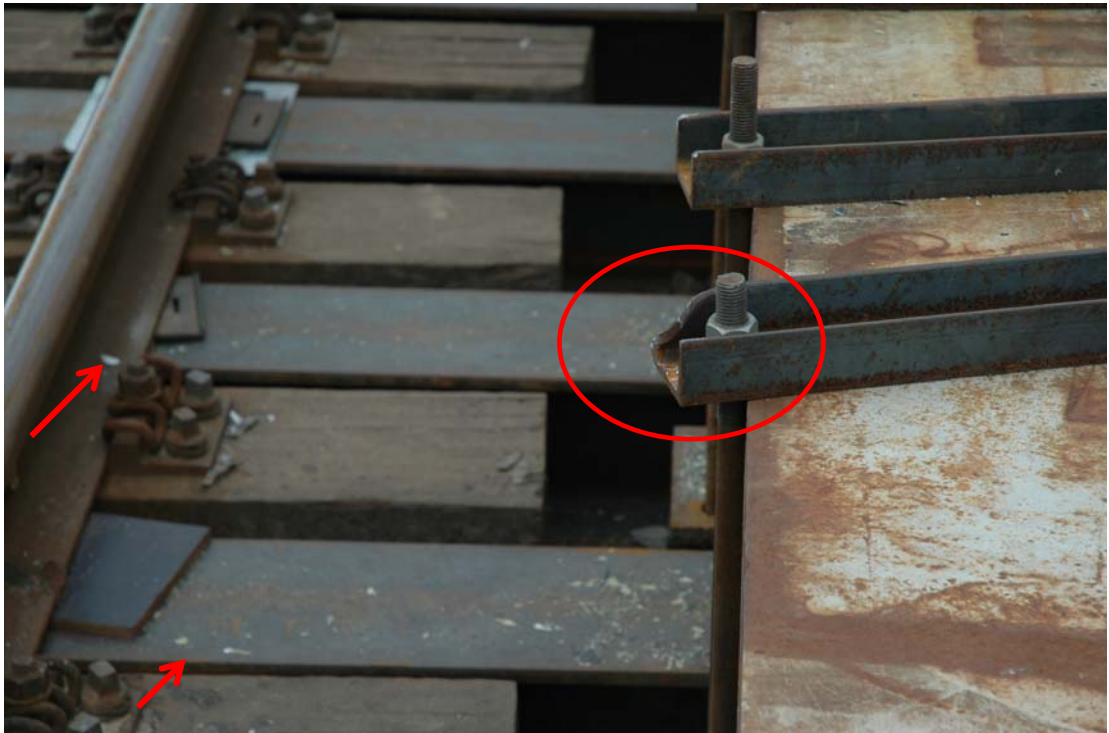
Figur 3, Påkørselsmærker på kassedrageren endvidere rester af afslået aluminium fra toget på øvrige stålbjælker mv.
