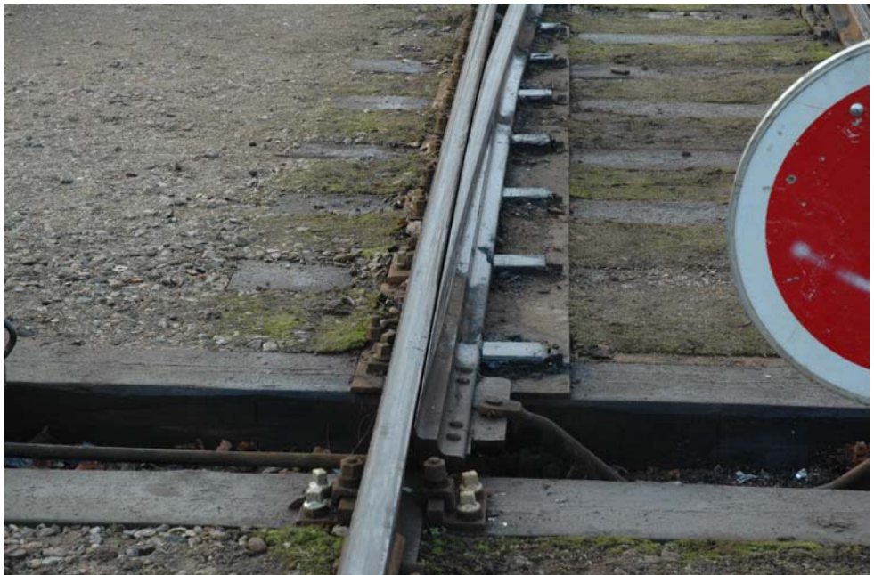
Figur 4. Her ses, at sporskiftetungen ikke er fuldstændig tilsluttet sideskinnen, når kontravægten hviler på trækstangen
