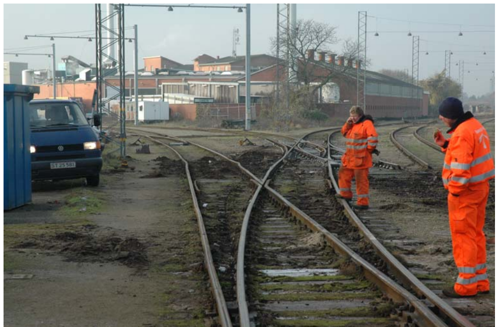
Figur 6. Det skadede spor efter afsporingen.
