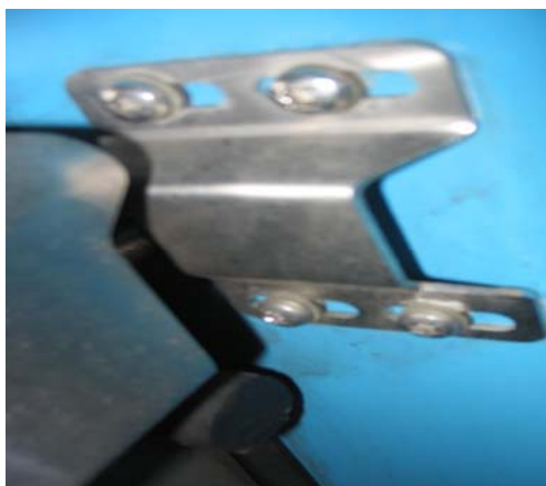
Foto 8: viser et korrekt låst sikringsbeslag og låsepal
