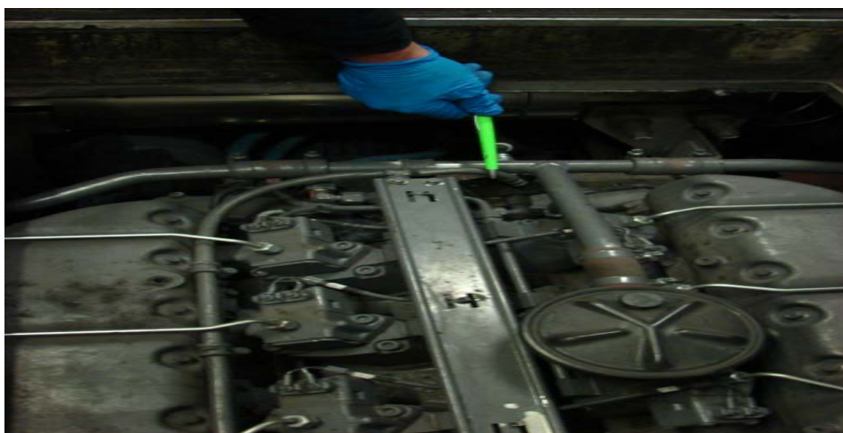
Foto 4: Brændstofslange uden brandskade
