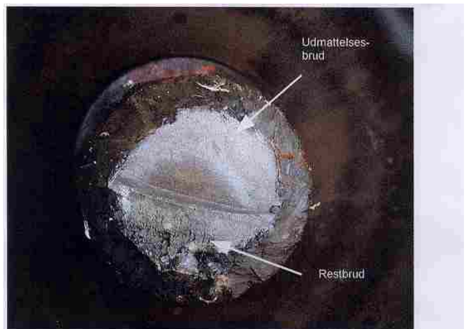
Figur 2: Nærbillede af brudfladen. Bemærk at kun de centrale dele af brudfladen er rimeligt velbevaret. Bruddet er vokset som et udmattelsesbrud startende fra oven. Restbruddet udgøres af den lysere og mere groft udseende del nederst i billedet.
