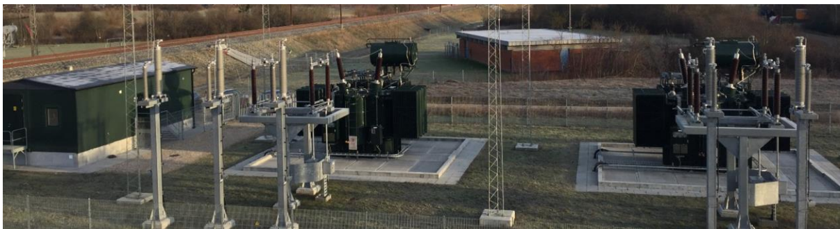
Figur 4 – Kildebrønne transformerstation [2 x 60 MVA]. Ny bane København-Ringsted
